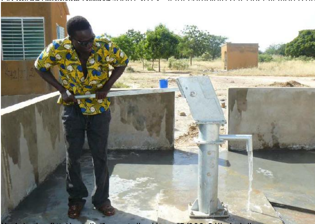
Le forage a été installé à un coût de 110 000 €. Le système est alimenté par une profondeur importante
